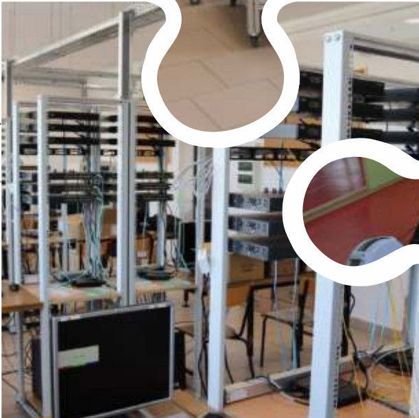
pracownia sieci komputerowych
