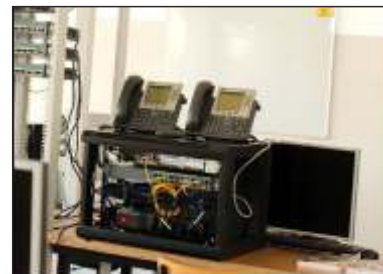
pracownia sieci komputerowych
